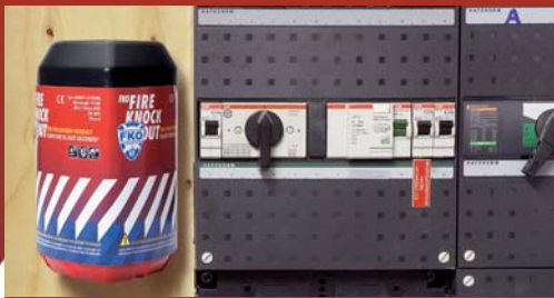
Meterkast of ketelruimte
